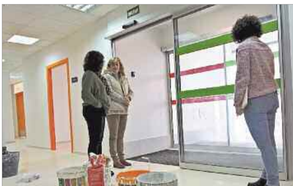
Se remodelaron los accesos principales, incorporando en uno de ellos un nuevo ascensor accesible
