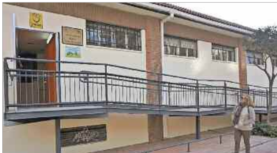
Se han mejorado la rampa accesible en la salida de emergencia y se han instalado dos nuevas cabinas de aseos accesibles, que cuentan con aparatos sanitarios específicos para personas con ostomía.
