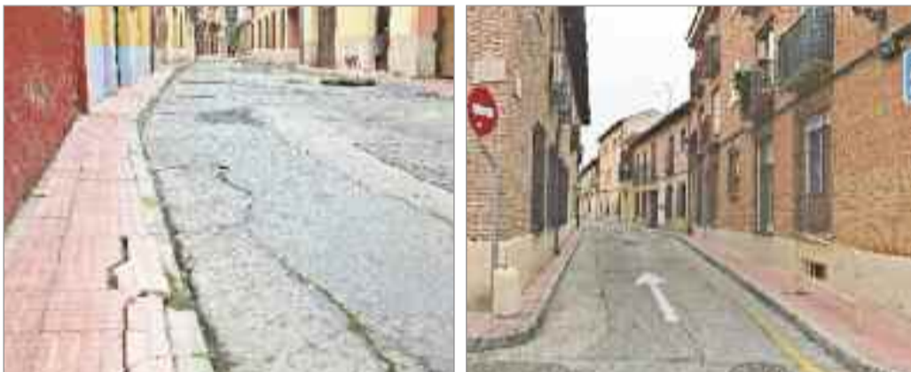
El proyecto contempla la creación de una plataforma única sin desniveles, manteniendo el tráfico de vehículos en la calle hasta llegar a la intersección con la Travesía Portilla en coexistencia con el peatón.
